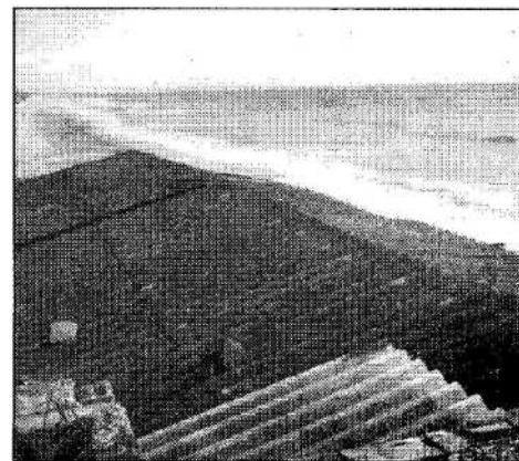
Immagine di amianto
